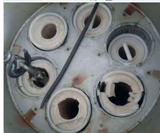
Из-за поломки торцевой крышки увеличиваются затраты на техническое обслуживание и время его проведения.
